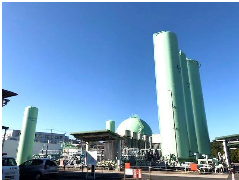
松江市ガス局LNGサテライト基地
